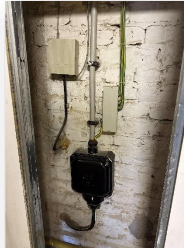
Anschl. Strom u. Telefon
