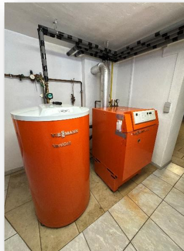
Boiler und Heizung
